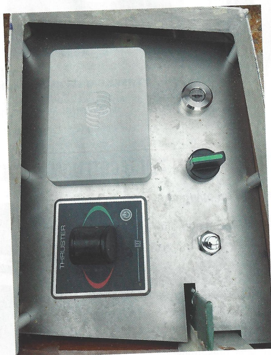
Het monitorpaneel ingebouwd, samen met de bedieningshendels van de boegschroef (Thruster) en de nieuwe gashendel van de elektromotor
